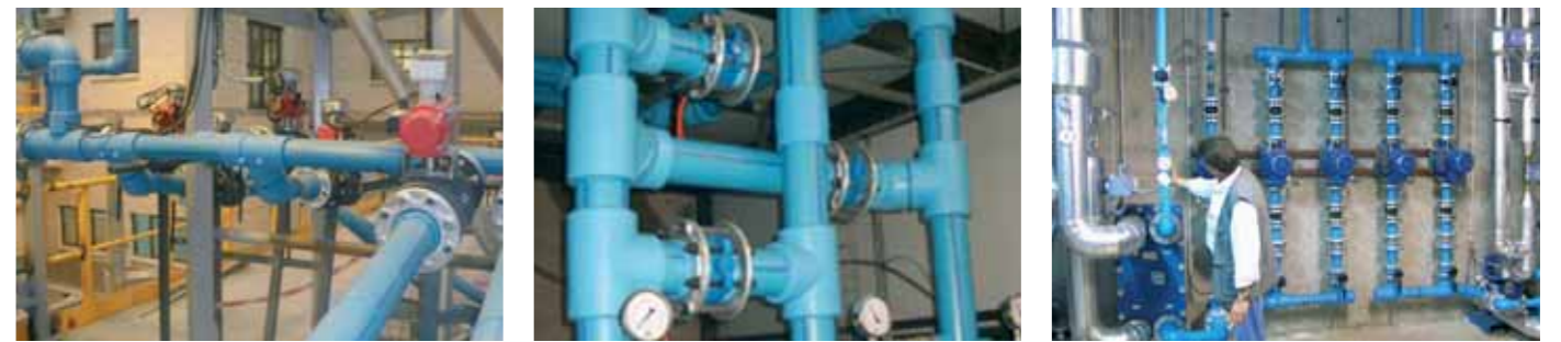
Instalaciones de climatización agua-agua y agua-aire.
